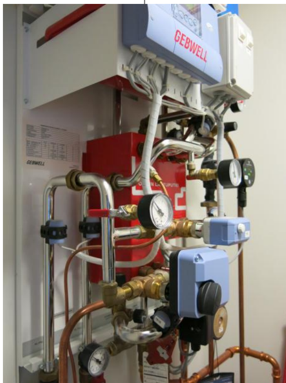
Juuri uusittu kaukolämmön lämmönvaihdin
