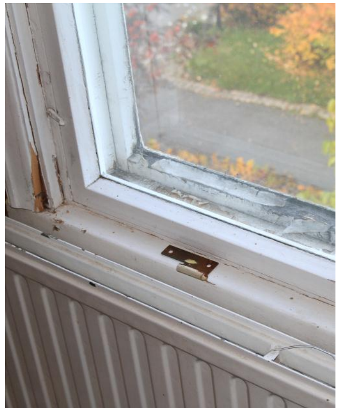
Sisään-ulos aukeava kaksilasinen MS-ikkuna, joka vaatii perusteellista kunnostamista tai uusimisen.
